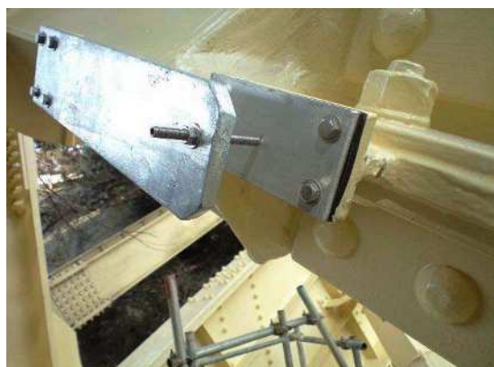
変位計測装置
